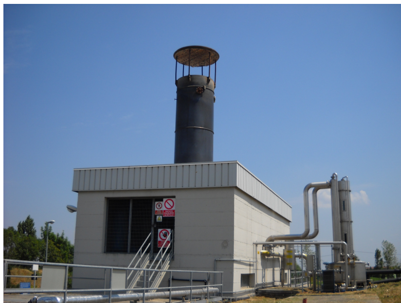
Vista della torcia di emergenza
