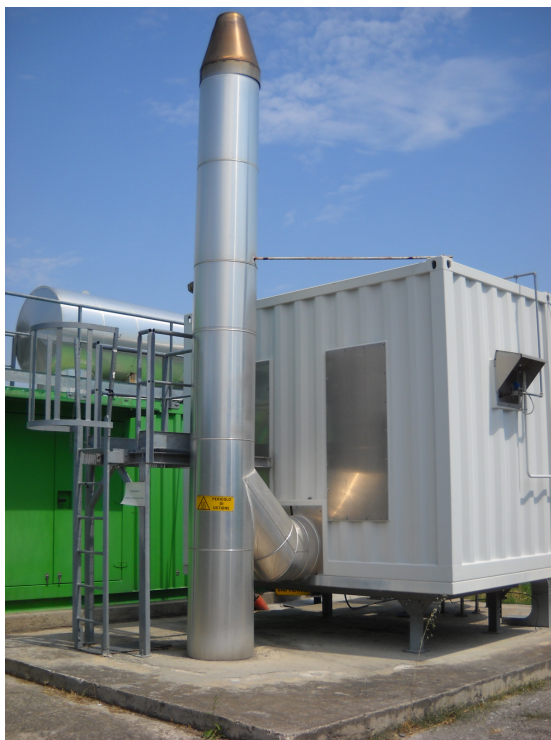
Vista di un motore per la cogenerazione del biogas
