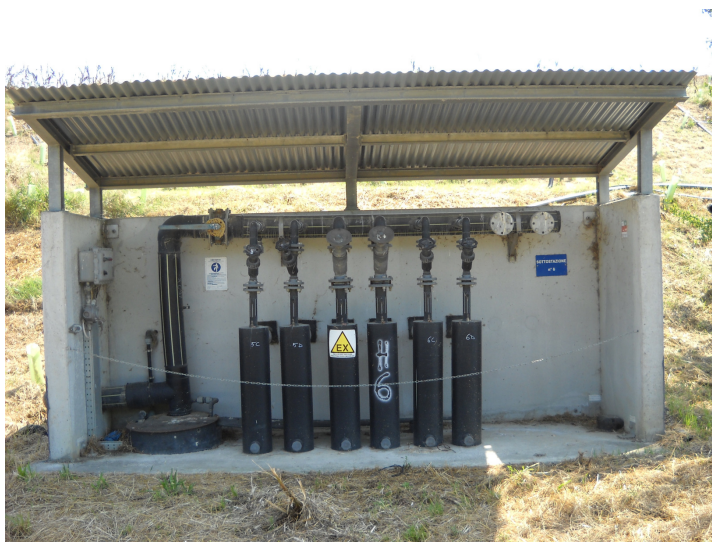
Vista di una sottostazione per la regolazione del biogas di discarica
