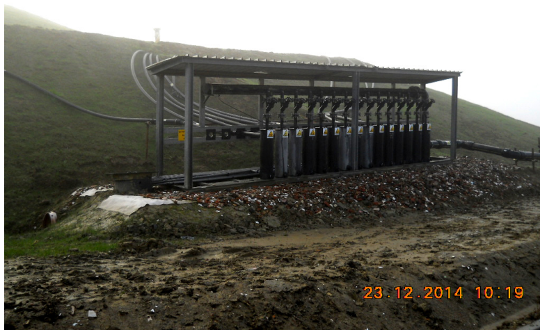
Vista di una sottostazione per la regolazione del biogas
