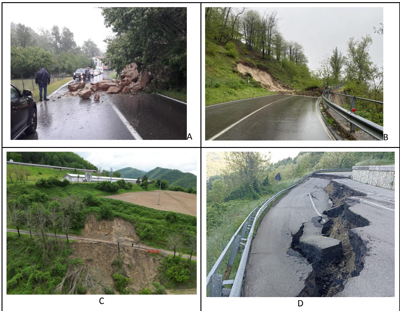
Figura 7: A e B: frane di monte su viabilità: A: Monterenzio , fondovalle Idice, B: Loiano, SS 65 Futa; C e D: frane che hanno danneggiato le infrastrutture: C: Casola Valsenio, strada Comunale; D: Monzuno, SP 59.
