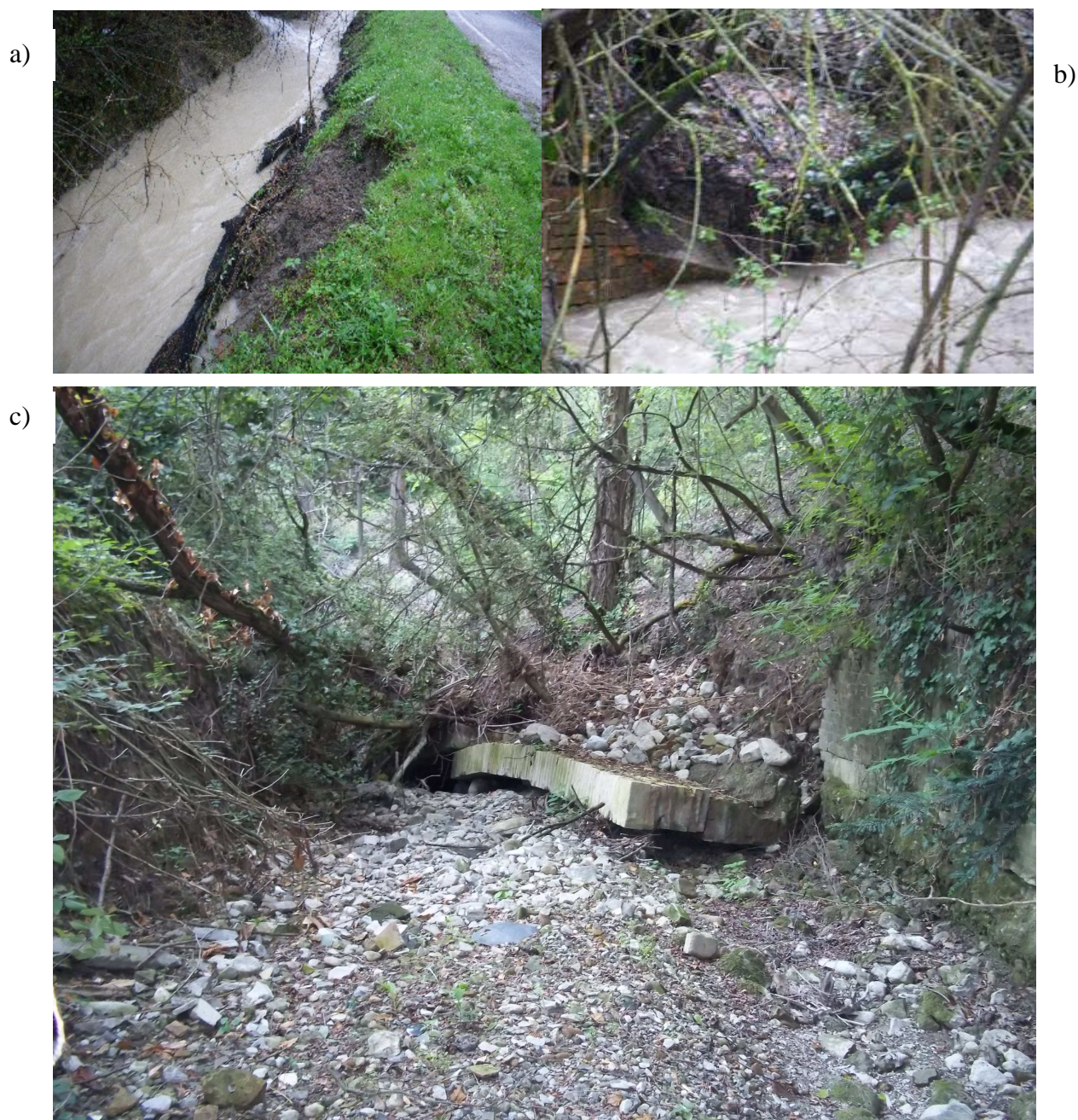
Figura 7: i pannelli (a) e (b) mostrano evidenti erosioni delle sponde in occasione della piena del 05 Aprile 2013 e il parziale cedimento di un muro di contenimento. Il pannello (c) mostra il totale collasso del muro di contenimento di cui sopra con parziale ostruzione dell'alveo del torrente (qui ripreso in Agosto 2013, in secca estiva). Da notare anche il ripido versante che ora incombe sul letto del torrente con terreno e alberi.
