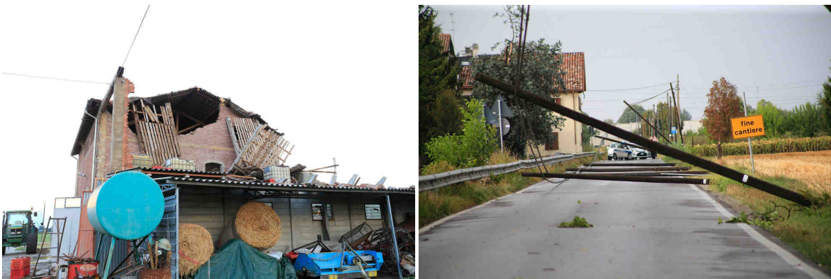
Figura 20. Danni causati dal vento tra Castelfranco e Spilamberto (MO). Fonte: Gazzetta di Modena.
