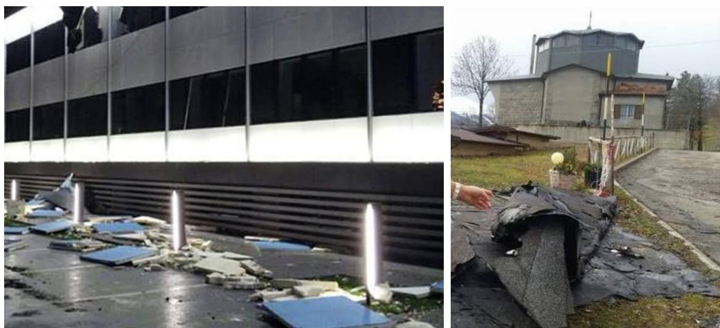
Figura 44. Danni provocati dal vento a Pavullo e a Lama Mocogno (Fonte: Modena Today e Resto del Carlino Modena).
