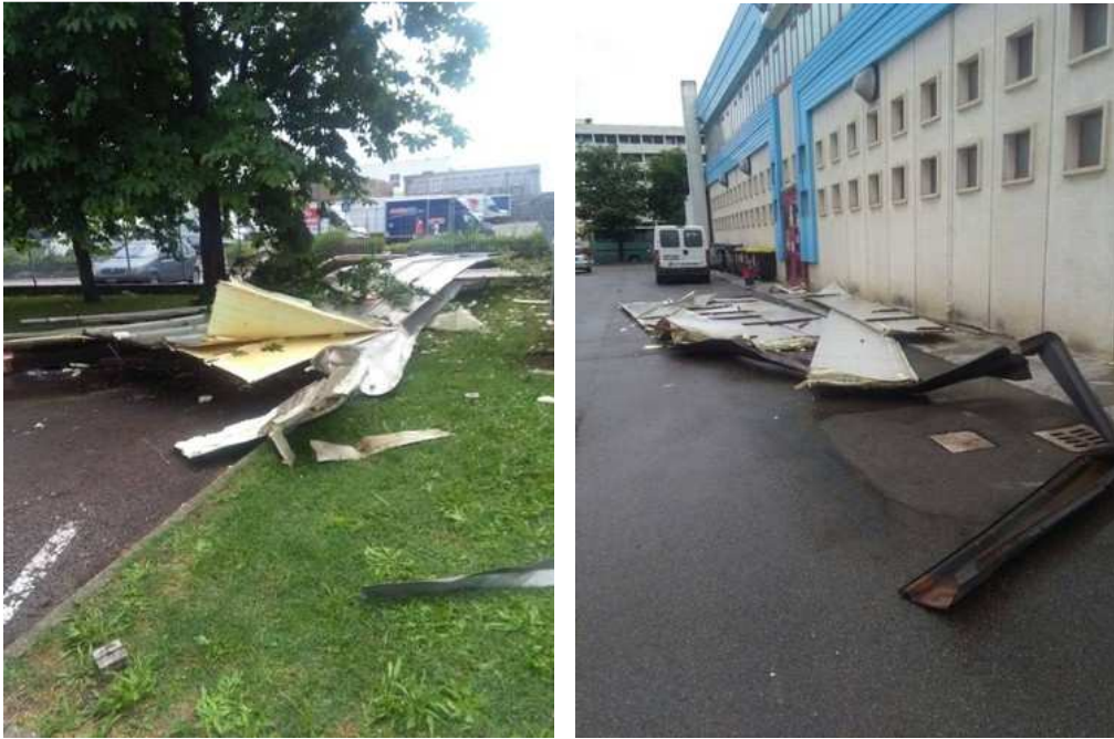
Figura 12. I danni al centro sportivo Pederzini a Calderara (BO), da “Il Resto del Carlino”.
