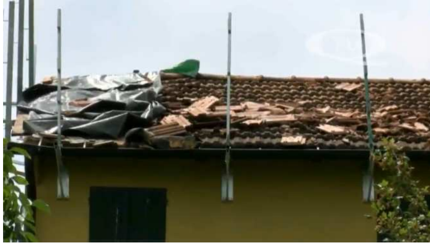
Figura 14. I danni al tetto di un'abitazione a Ravarino, frazione di Stuffione (MO), da "tvqui Modena".
