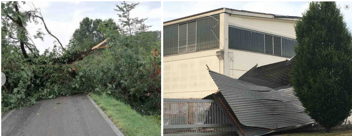
Figura 21. Albero caduto a Viarolo nel parmense; fonte: Gazzetta di Parma (a sinistra). Copertura abbattuta nella bassa parmense; fonte: Gazzetta dell'Emilia (a destra).
