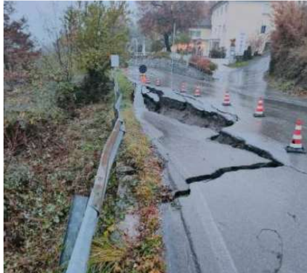
Figura 36: Frana a Castel di Casio sulla SP40 (fonte il Resto del Carlino)
