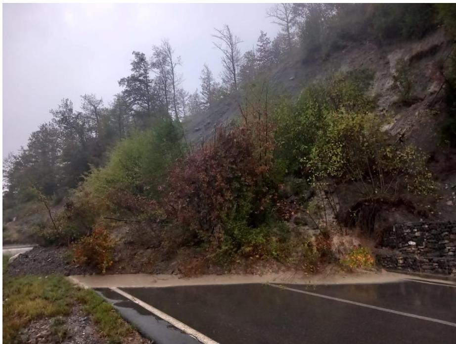
Figura 45: Scivolamento superficiale della coltre in località Miano. (fonte: pagina facebook del Comune di Corniglio)
