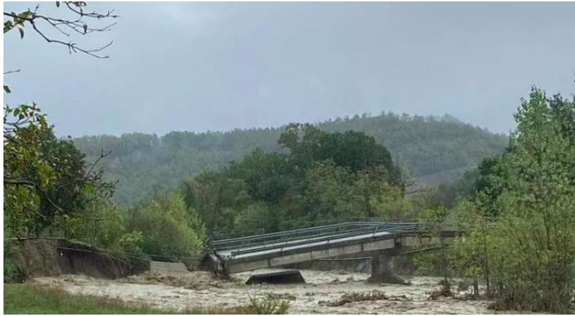
Figura 36: Crollo del ponte di Ozzanello sul Taro (PR) (foto da La Repubblica)
