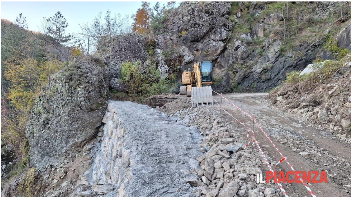
Figura 50: lavori successivi al crollo in località Castagnola.
