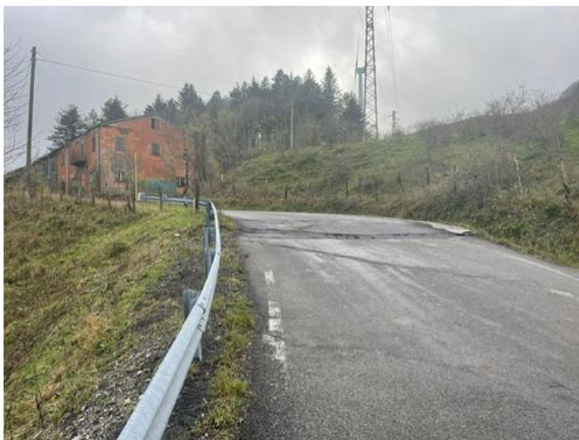
Figura 41: Frana per scorrimento rototraslativo in corrispondenza della SS 523 del Cento Croci.
