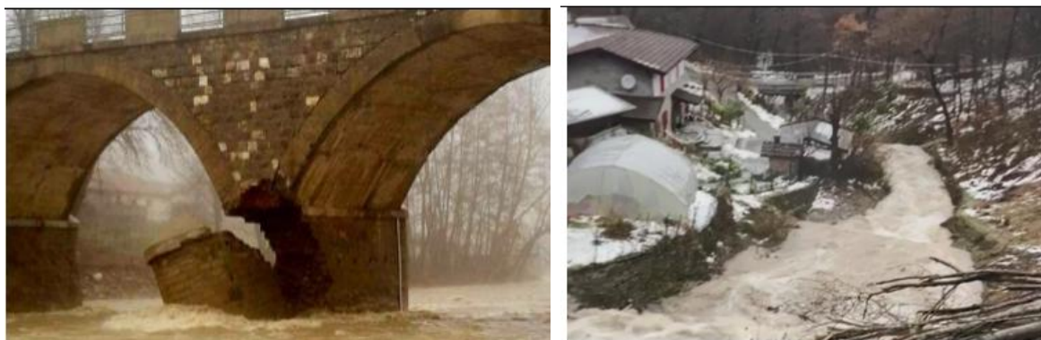
Figura 39: Il danneggiamento di una pila del ponte Samone, a sinistra e i fenomeni erosivi delle sponde destra e sinistra con pericolo di interessamento abitazioni nel comune di Sestola (fonte Protezione Civile)
