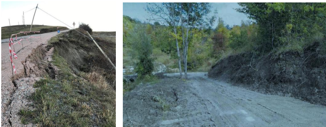
Figura 56: Movimento franoso in località Ugrigno (a sinistra) e in località Soanne (a destra) (foto Agenzia regionale per la sicurezza territoriale e la protezione civile).
