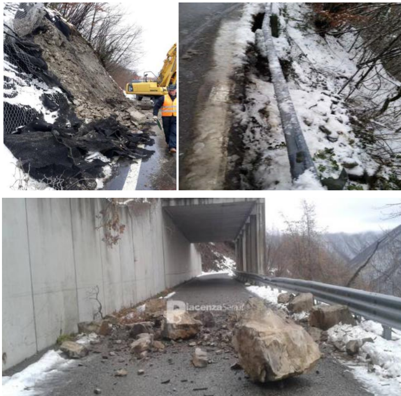
Figura 48: Tipologia di fenomeni franosi che hanno interessato la viabilità provinciale piacentina: SP 654R di Val Nure km 51+000 (in alto a sinistra), SP 586R della Val d'Aveto km 3+200 (in alto a destra) e SP 18 di Zerba (in basso) (foto in alto: Agenzia Regionale di Protezione Civile. In basso: foto da Piacenza sera.it del 5/12/2020).
