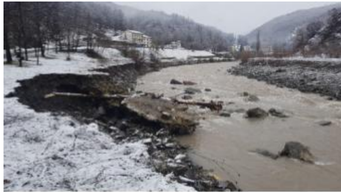
Figura 31: Erosione in destra idraulica per circa 1,5 km nel Comune di Montefiorino del torrente Dolo (fonte Protezione Civile).
