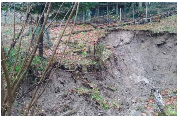
Figura 53: Uno dei movimenti franosi che hanno interessato il Comune di Lizzano in Belvedere (foto: il Resto del Carlino del 7/12/2020).
